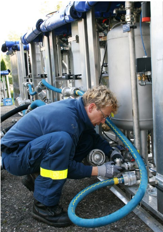
Abbildung 5: Fachgruppe Trinkwasser betreibt Trinkwasseraufbereitungsanlage UF-15 (Bildquelle: THW)
