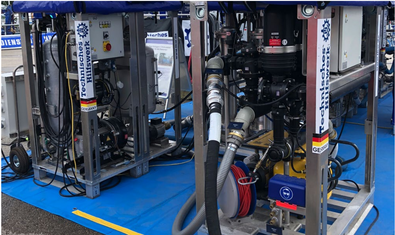
Abbildung 20: UF-15 Anlage des THW (Bildquelle: SWA)
