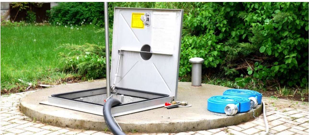
Abbildung 19: Beispiel eines Trinkwassernotbrunnens als Beispiel eines leitungsunabhängigen Brunnen (Bildquelle: P. Fischer, BBK)
