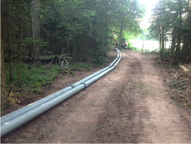
Abbildung 21: Ersatz- oder Notversorgung über mobile Leitungen (Bildquelle: Merbs, 2018)
